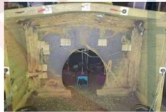
連續板嚴重變形及柱板上拱 (G2-4 試體破壞)
